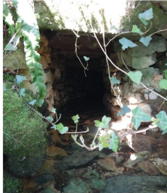
Sortie avant le premier bassin.
